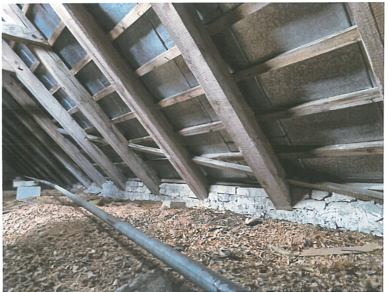
Kaplica Moñki stan poddasza.
